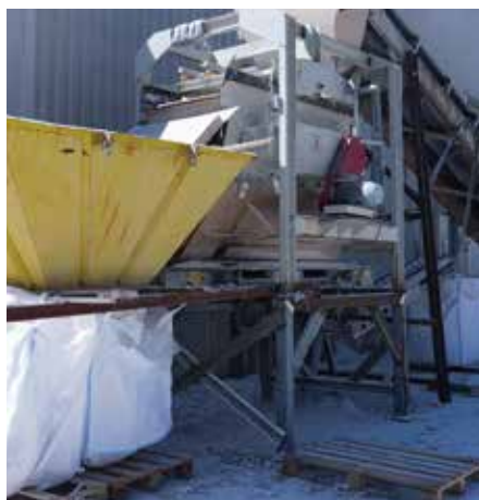
→ Cette installation a récemment broyé 40 m 3 de plaques de plâtre en une semaine pour un client basé à l'étranger.
